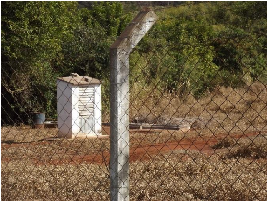
Foto 6.34 – Estação Elevatória da Estação de Tratamento
