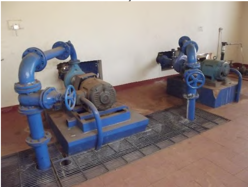
Foto 6.22 – Sistema de Bombeamento da Antiga Estação
