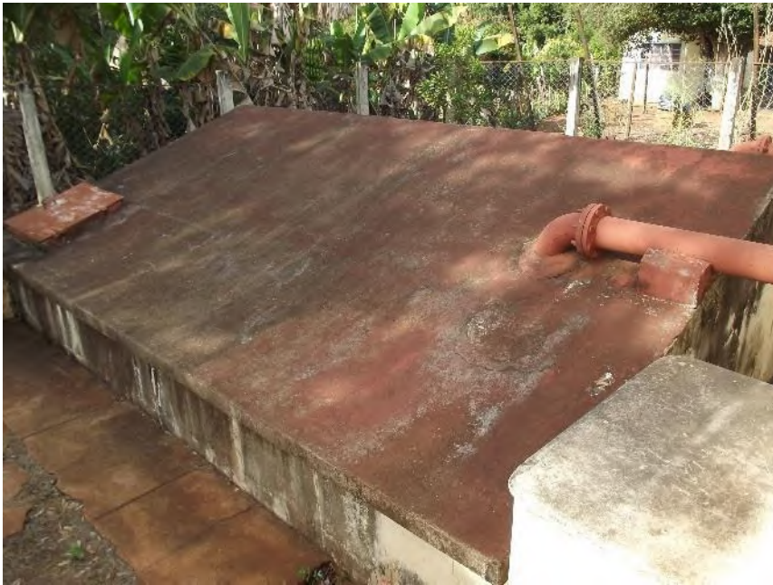
Foto 6.7 – Caixa de Recalque
