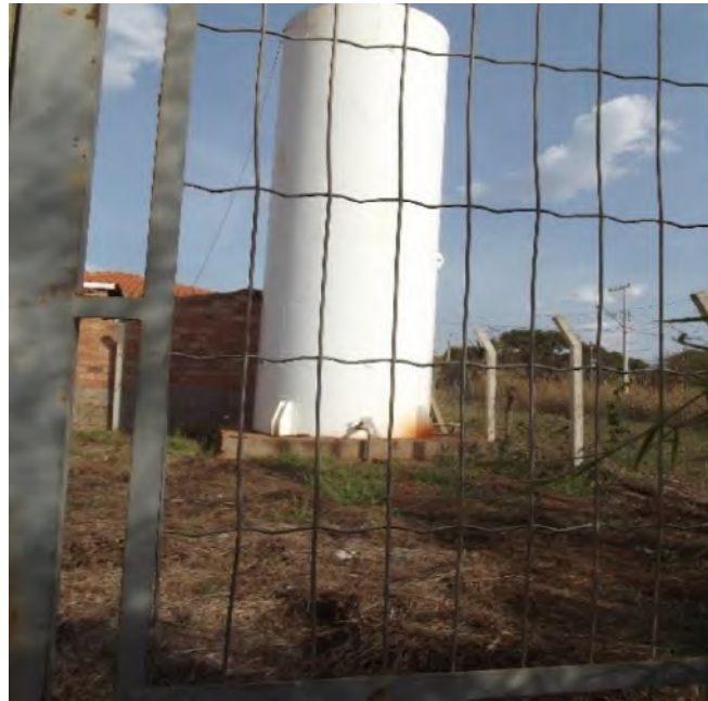
Foto 6.9 – Reservatório Jd. Alvorada
