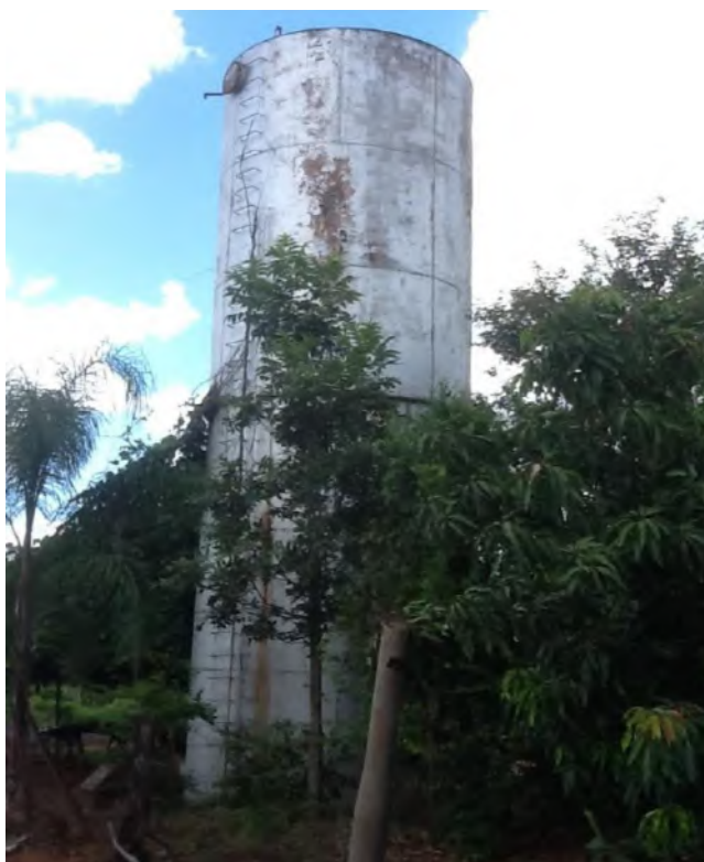
Foto 6.31 – Reservatório Distrito Cupurá
