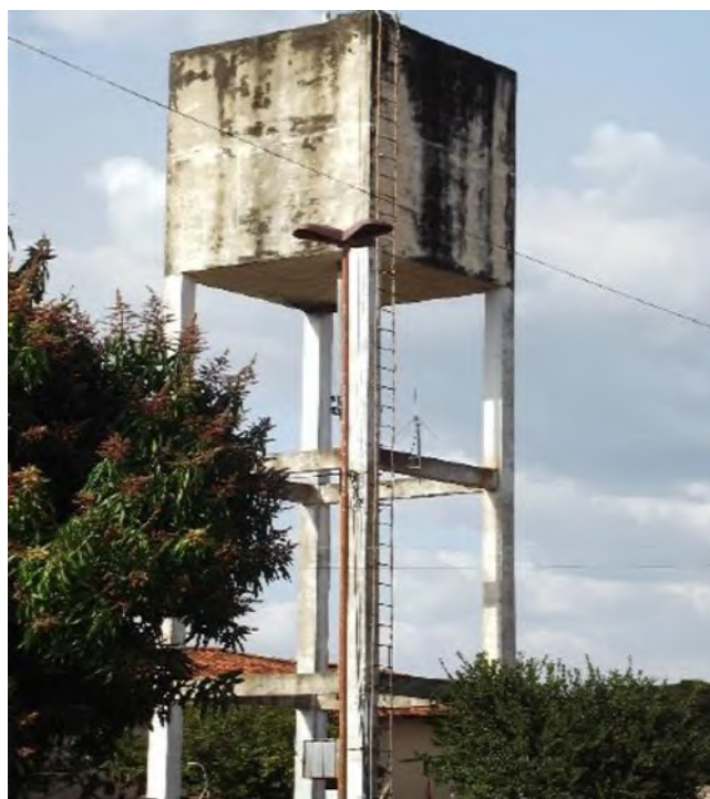
Foto 6.13 – Reservatório Jd. Bela Vista IV
