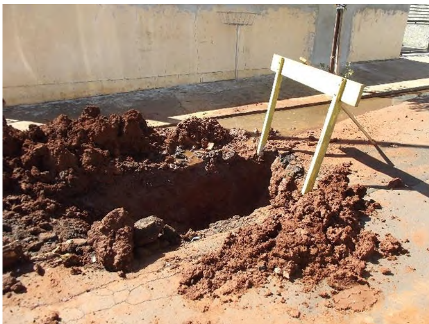
Foto 6.32. – Ponto de Manutenção da Rede de Distribuição.
