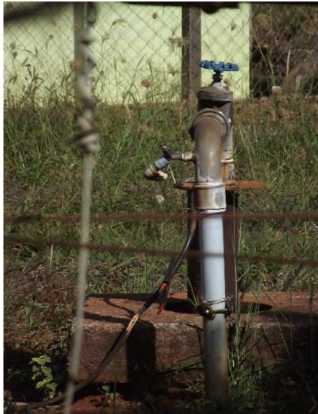
Foto 6.19 – Poço Distrito Industrial
