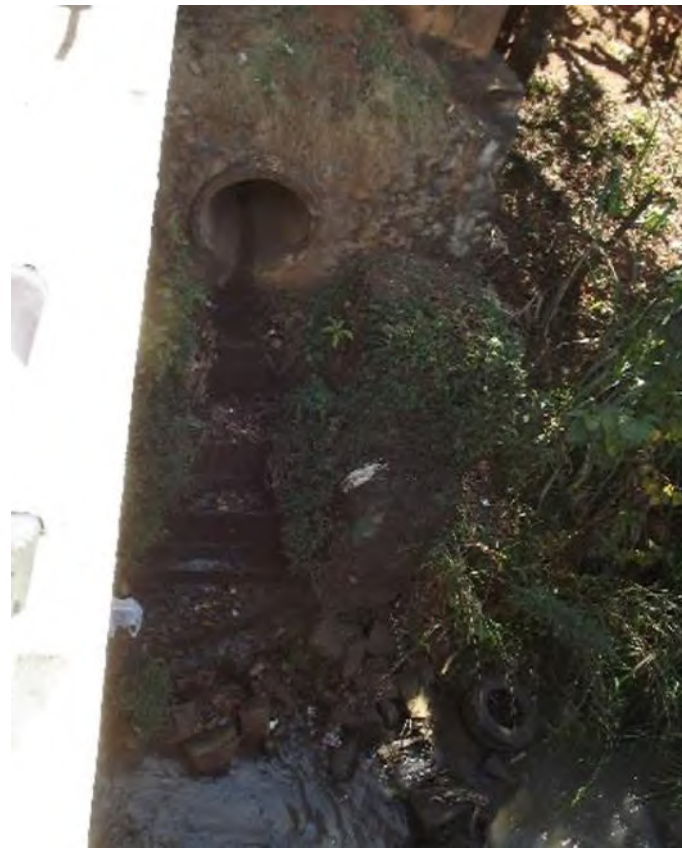
Foto 6.44 – Chegada de Drenagem Pluvial junto ao Córrego São João
